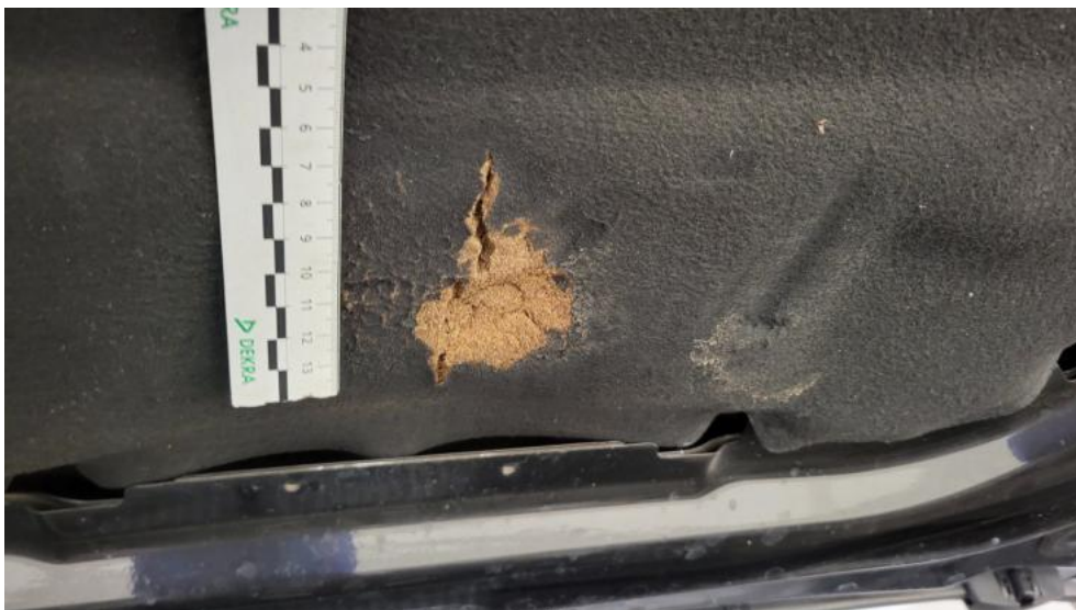
Fot. 58. Wykładzina pokrywy komory silnika - Pęknięcie/rozerwanie 1
