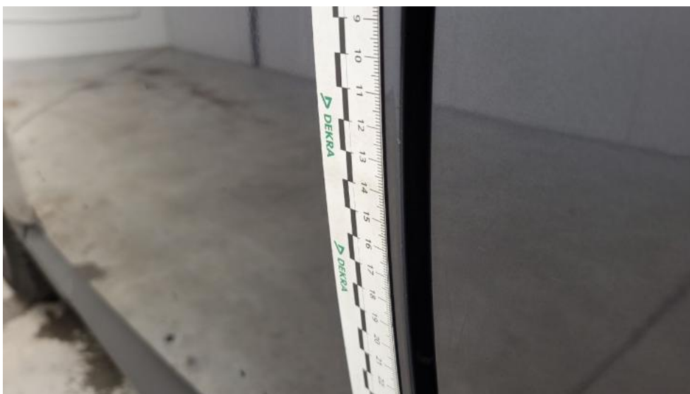
Fot. 51. Drzwi przed L - Rysa/odprysk 1
