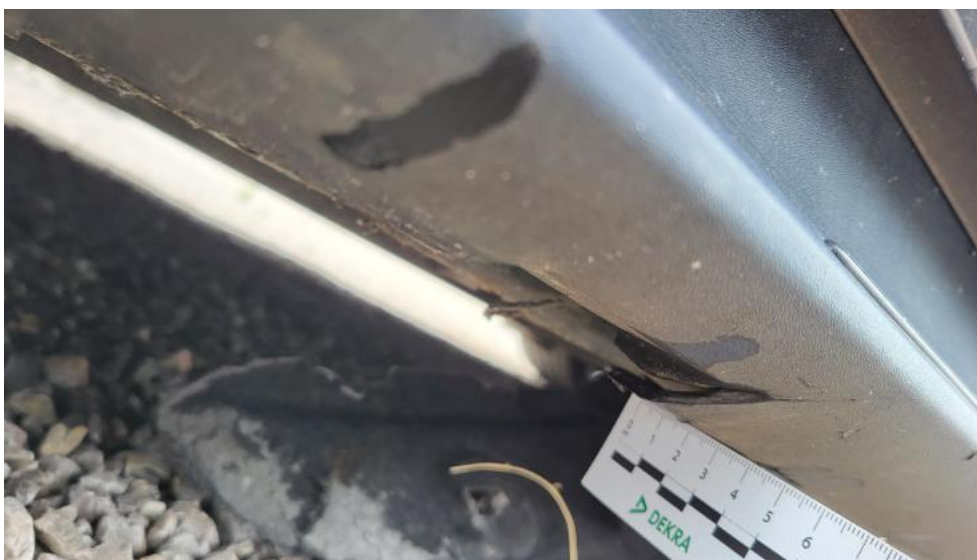
Fot. 90. Próg L - Pęknięcie/rozerwanie 1
