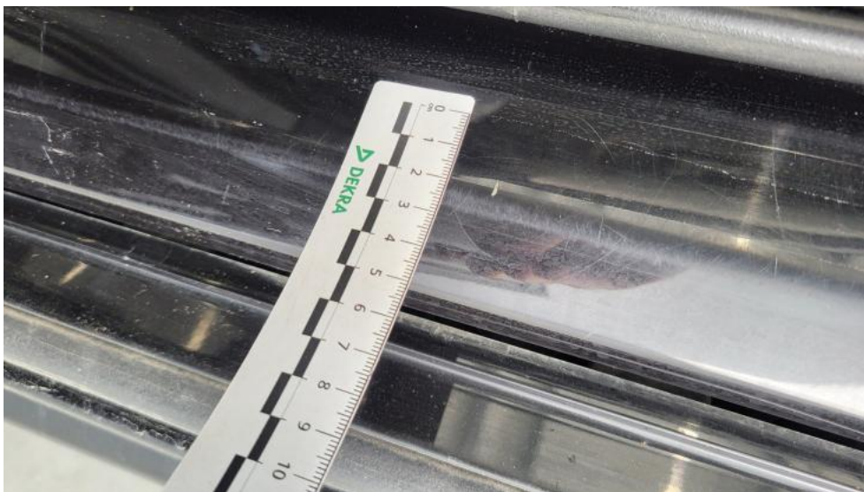
Fot. 113. Próg L - Rysa/odprysk 1
