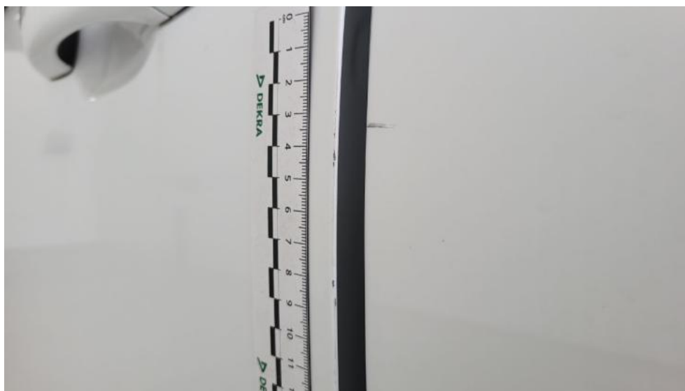
Fot. 49. Drzwi przed L - Rysa/odprysk 1
