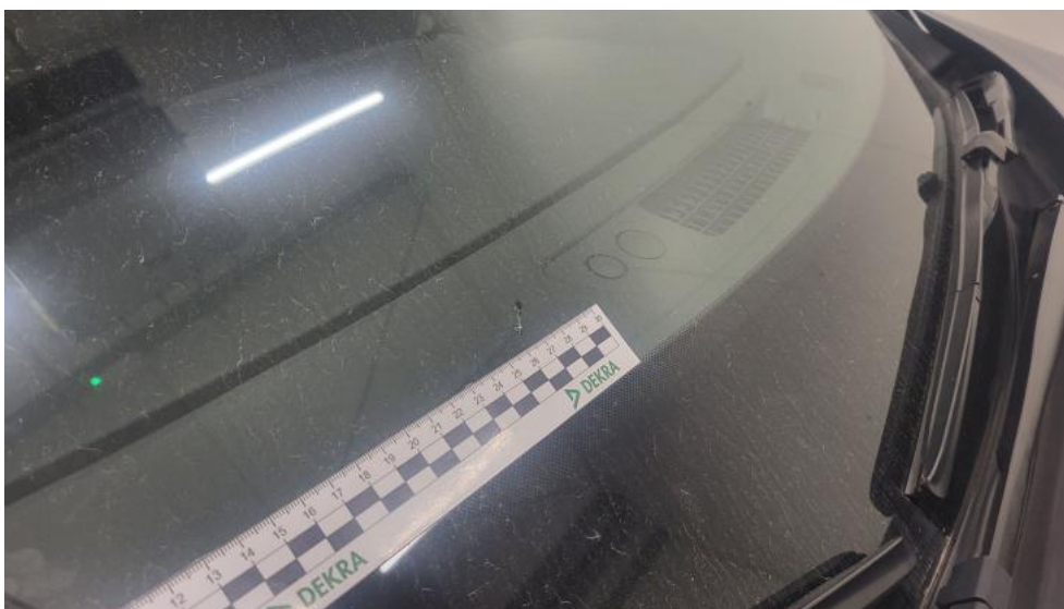
Photo 35. Szyba czołowa - Pęknięcie/rozerwanie 1
