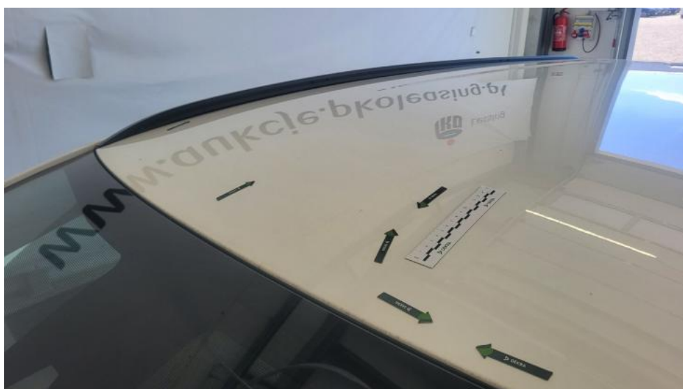
Fot. 76. Dach - Wgniecenie/odkształcenie 2
