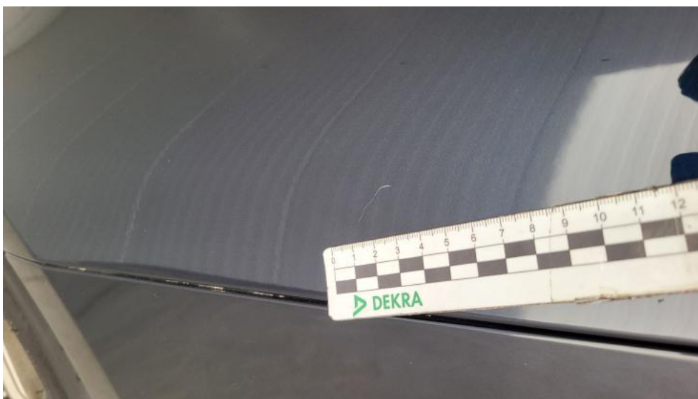
Fot. 77. Błotnik tylny L / Ściana boczna L - Rysa/odprysk 1
