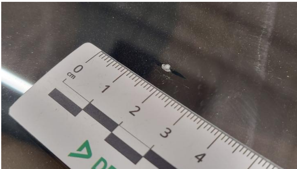
Fot. 39. Szyba czołowa - Pęknięcie/rozerwanie 1
