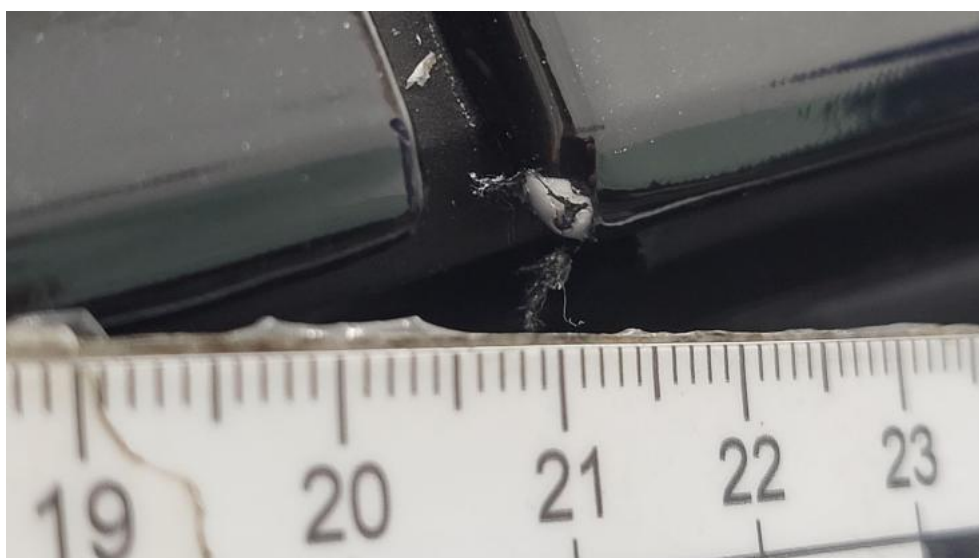
Fot. 78. Dach - Rysa/odprysk 2
