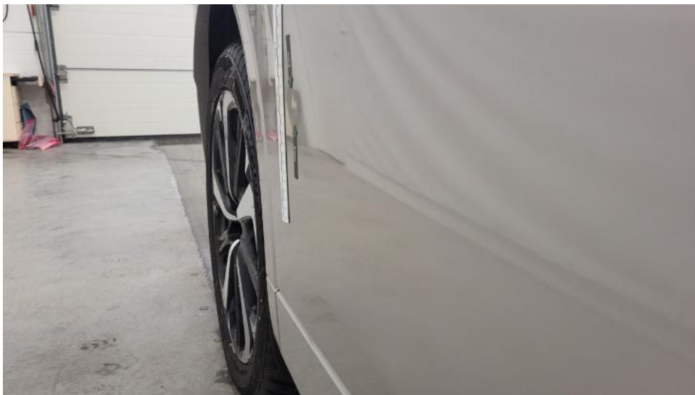
Photo 49. Drzwi tylne P - Wgniecenie/odkształcenie 1
