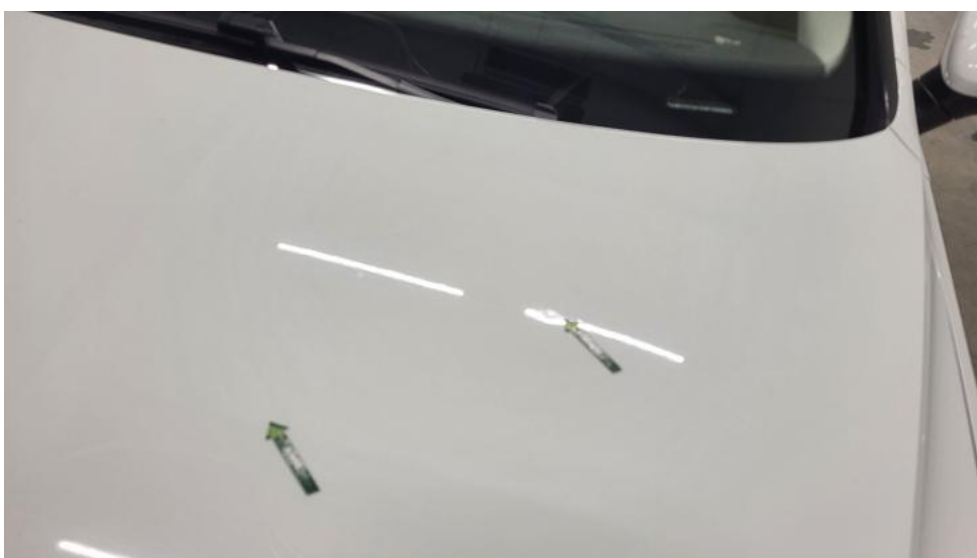
Fot. 62. Pokrywa komory silnika - Wgniecenie/odkształcenie 2
