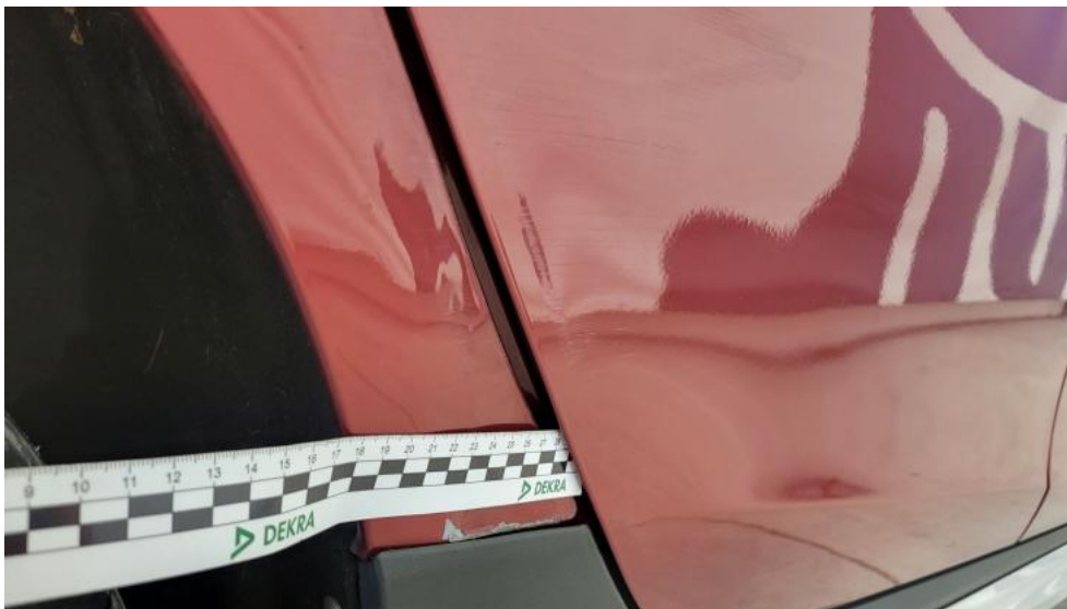
Fot. 81. Błotnik tylny P / Ściana boczna P - Inne 1
