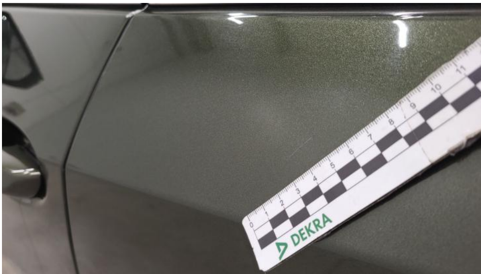
Photo 71. Drzwi tylne L - Rysa/odprysk 1
