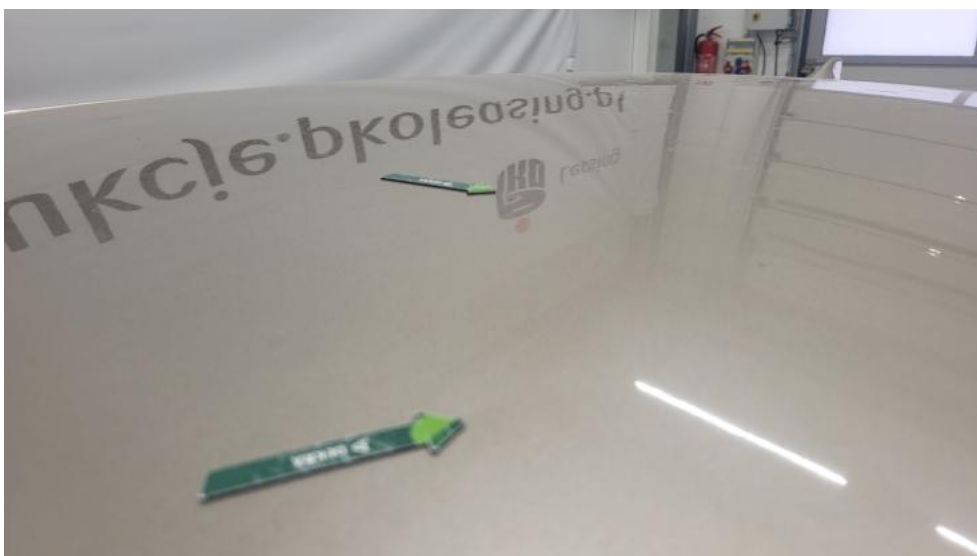
Fot. 44. Dach - Wgniecenie/odkształcenie 1
