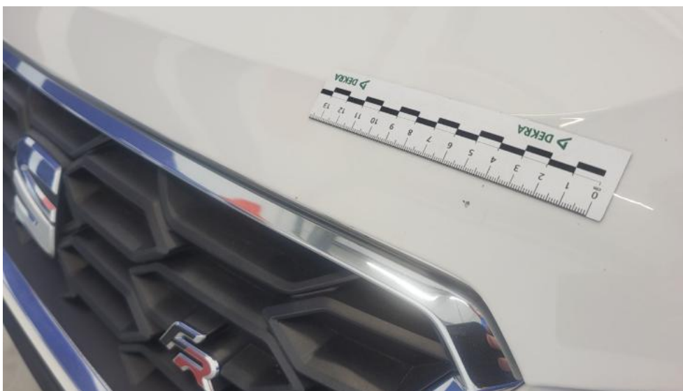
Photo 39. Pokrywa komory silnika - Rysa/odprysk 1
