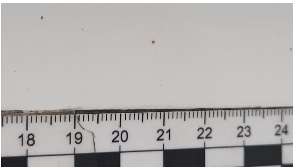
Photo 68. Drzwi tylne P - Inne 1
