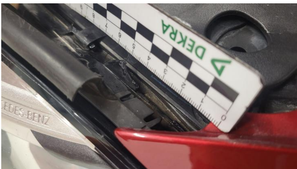
Fot. 76. Reflektor L - Pęknięcie/rozerwanie 1
