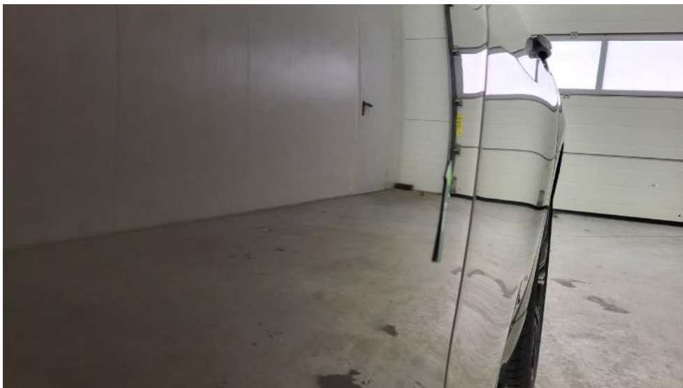
Photo 57. Drzwi przed L - Wgniecenie/odkształcenie 1
