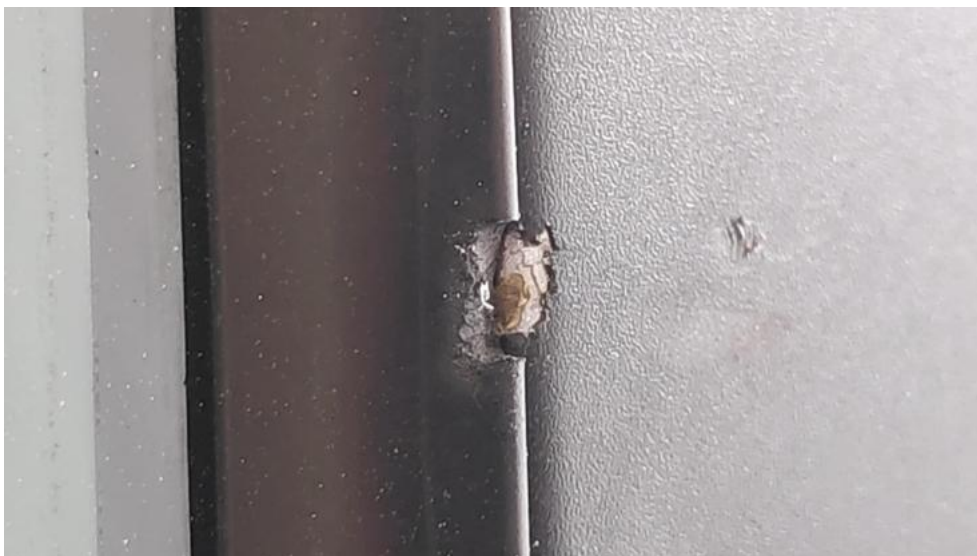
Fot. 61. Drzwi przed L - inne
