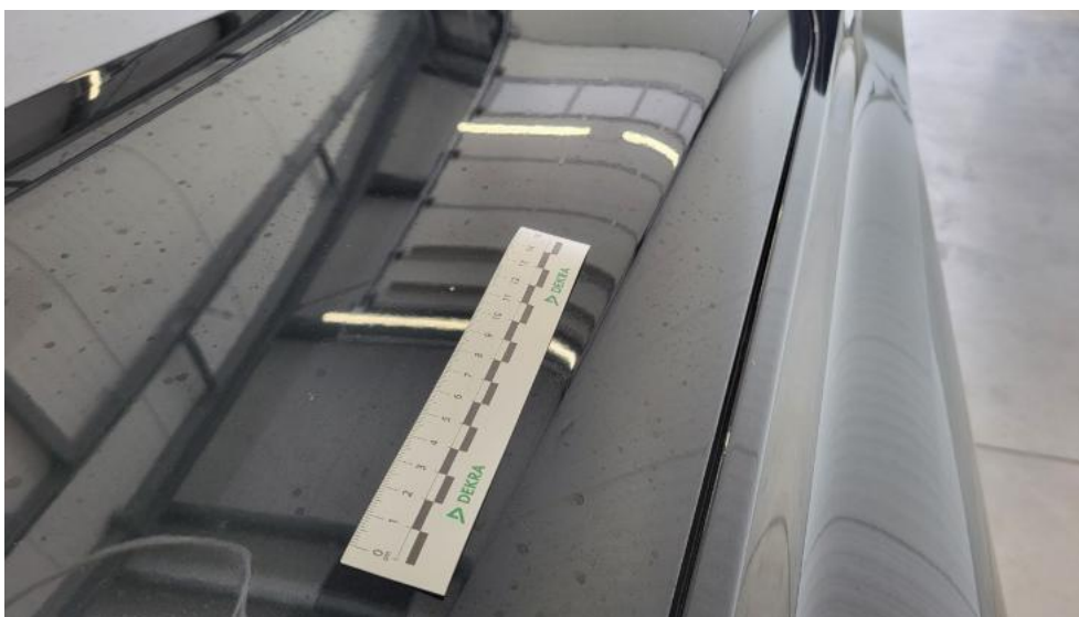
Fot. 41. Pokrywa komory silnika - Rysa/odprysk 1
