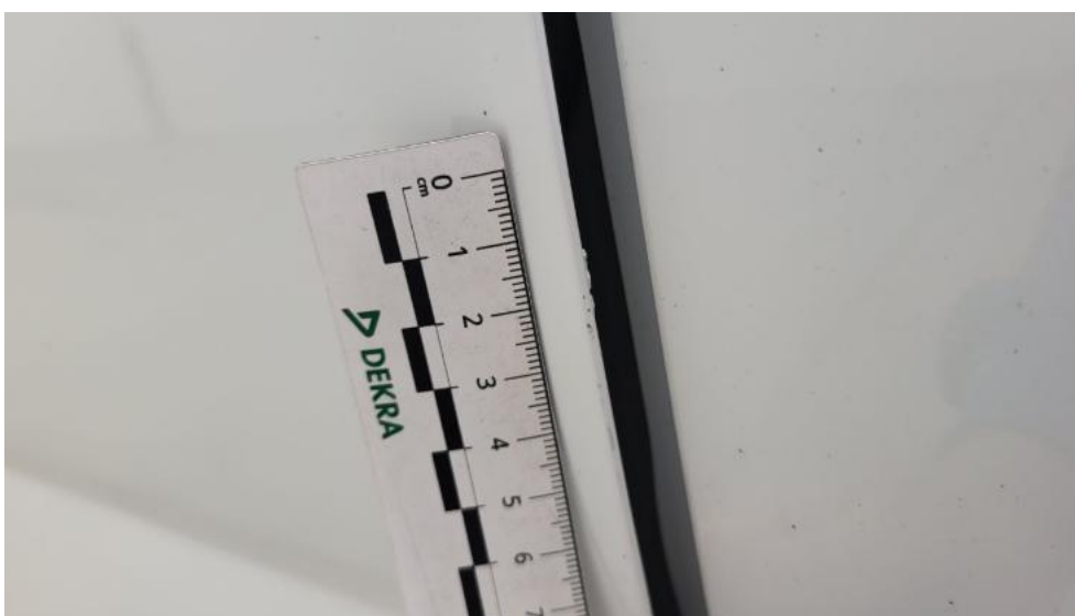
Fot. 54. Drzwi przed L - Rysa/odprysk 1
