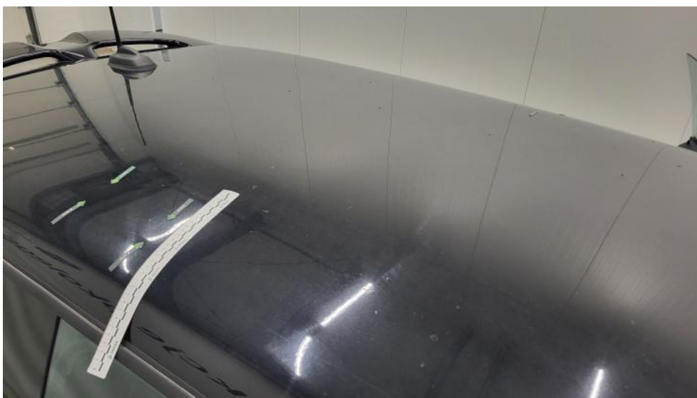
Fot. 68. Dach - Wgniecenie/odkształcenie 1
