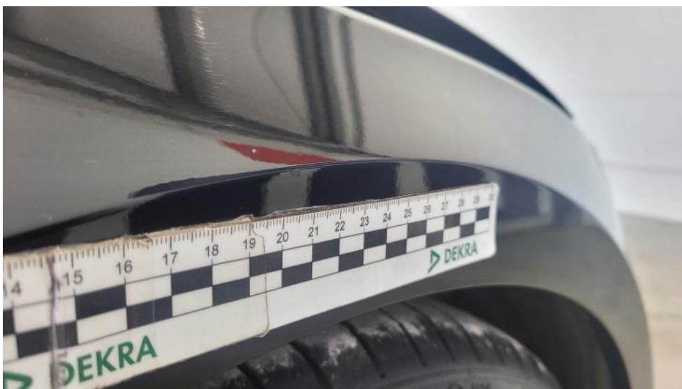
Fot. 64. Błotnik przedni P - Rysa/odprysk 2
