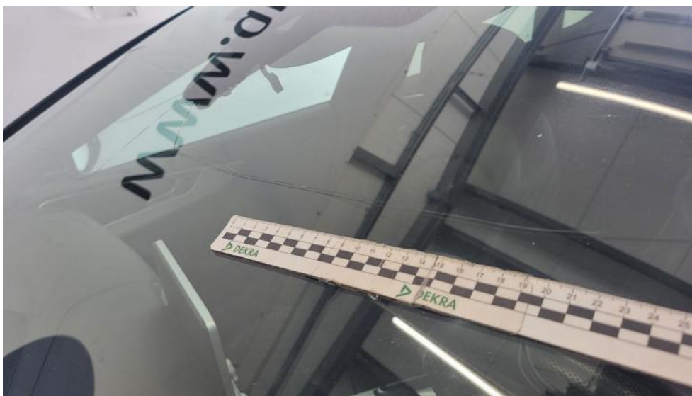
Fot. 57. Szyba czołowa - Pęknięcie/rozerwanie 1
