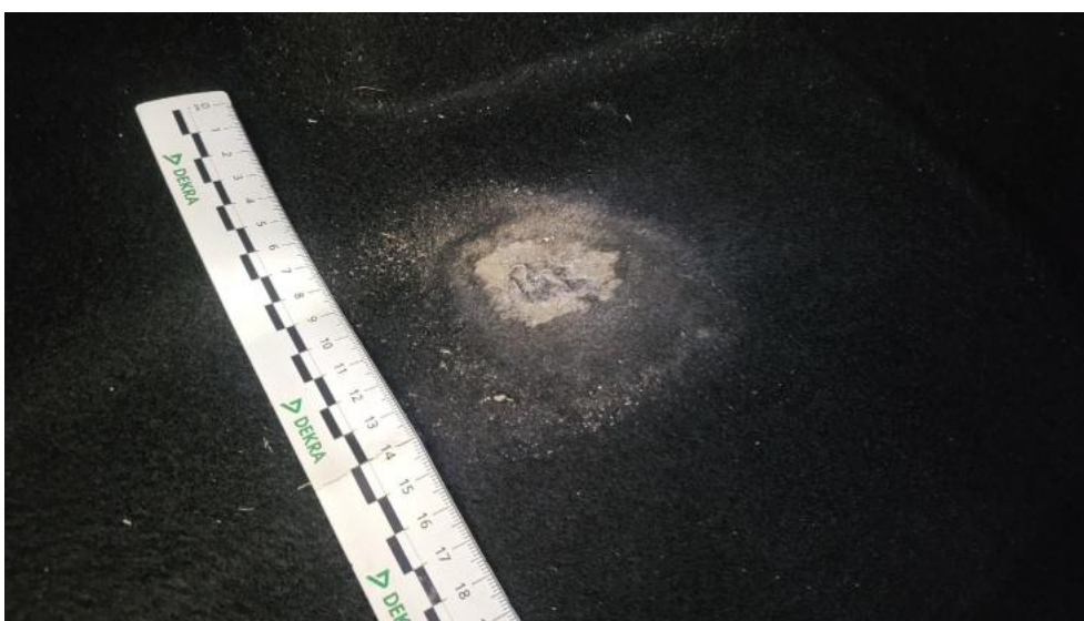
Fot. 74. Wykładzina podłogi - Pęknięcie/rozerwanie 1
