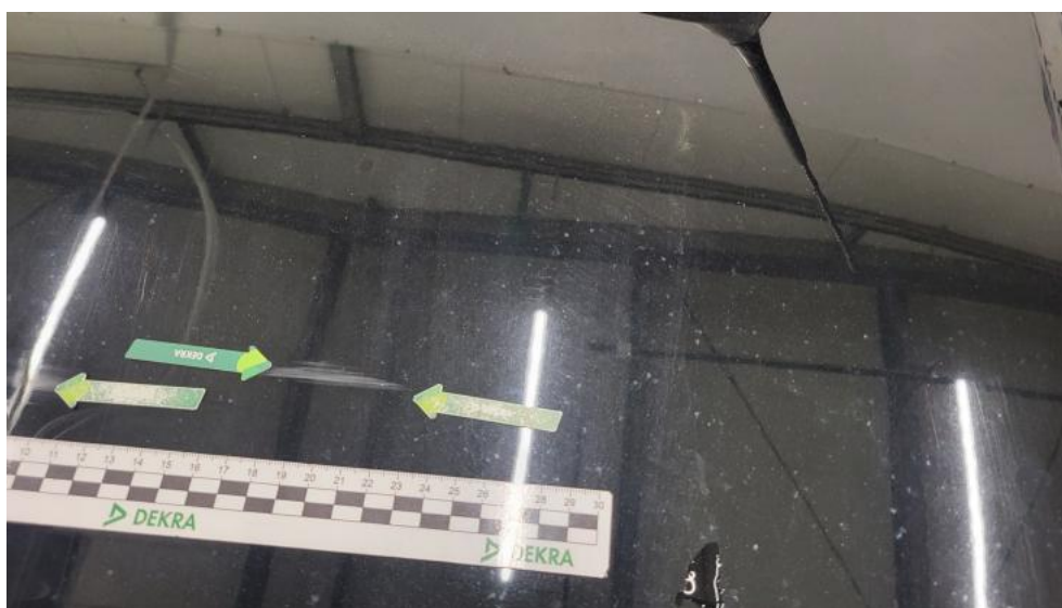
Fot. 69. Dach - Wgniecenie/odkształcenie 1
