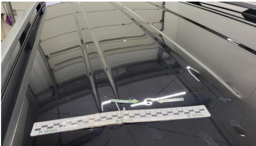
Fot. 63. Dach - Wgniecenie/odkształcenie 1
