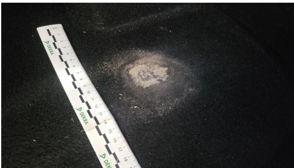
Photo 74. Wykładzina podłogi - Pęknięcie/rozerwanie 1
