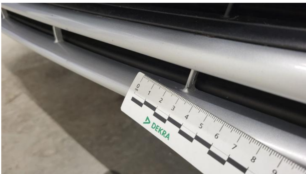
Fot. 42. Zderzak - Pęknięcie/rozerwanie 1
