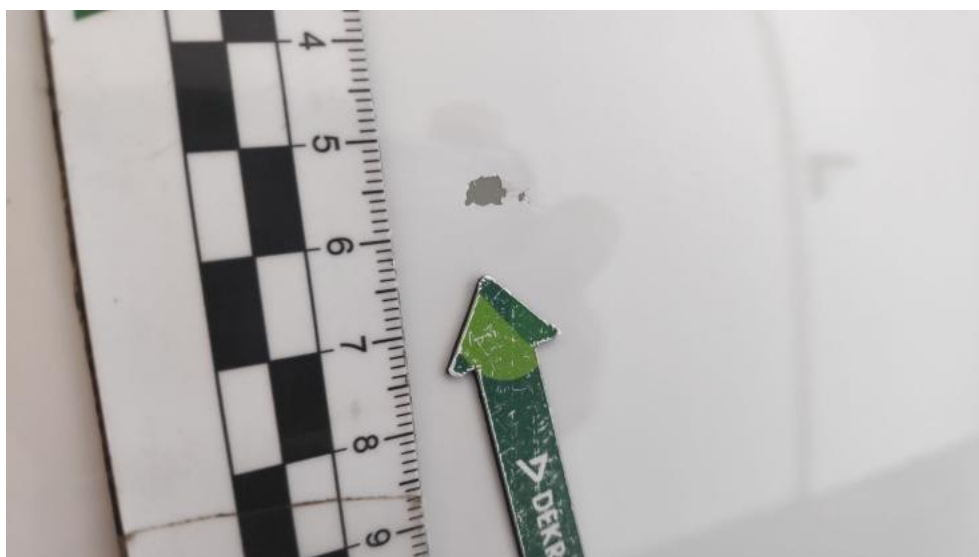
Fot. 51. Drzwi przed L - Rysa/odprysk 1
