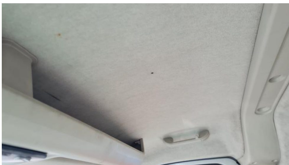
Fot. 64. Podsufitka - zdjęcie poglądowe 1
