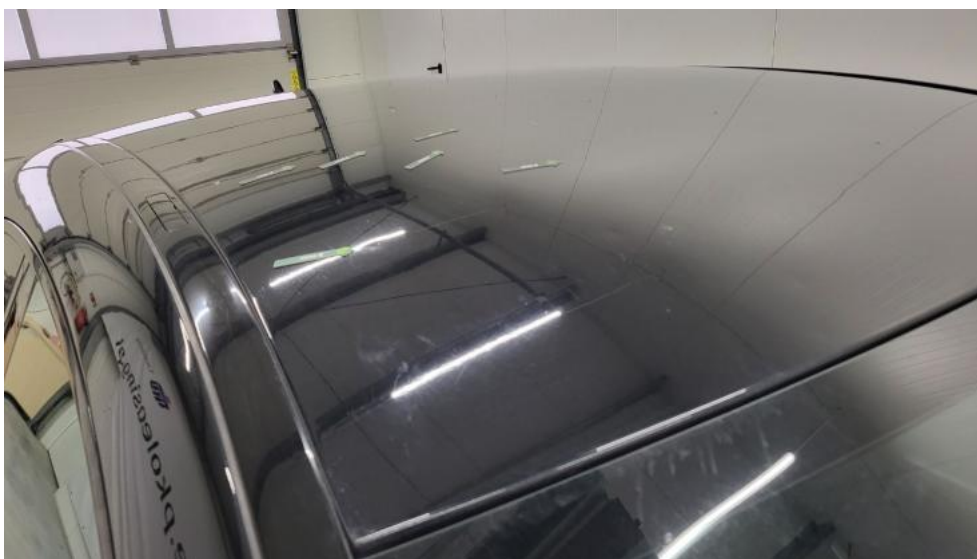
Fot. 59. Dach - Wgniecenie/odkształcenie 1
