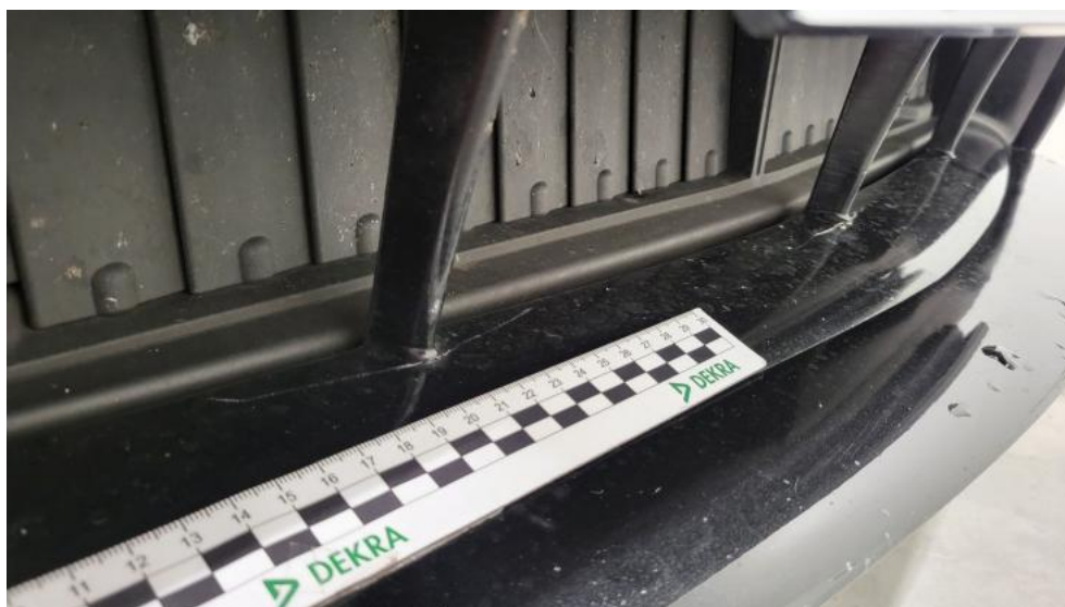
Fot. 40. Krata zderzaka prz. - Pęknięcie/rozerwanie 1
