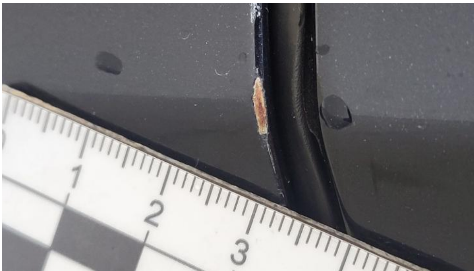
Fot. 73. Drzwi przed L - Inne 1
