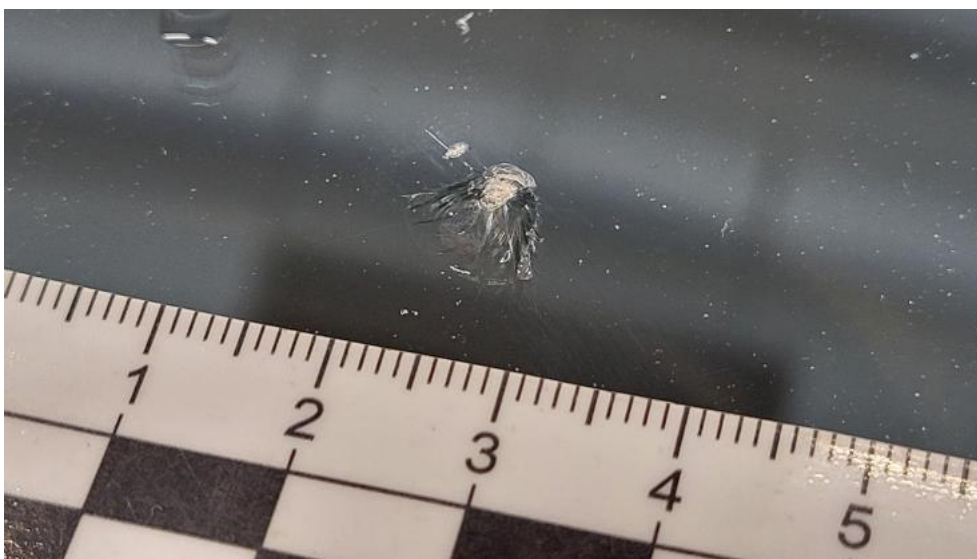
Fot. 45. Szyba czołowa - Pęknięcie/rozerwanie 1
