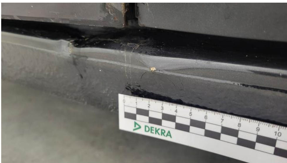
Fot. 90. Próg P - Pęknięcie/rozerwanie 1
