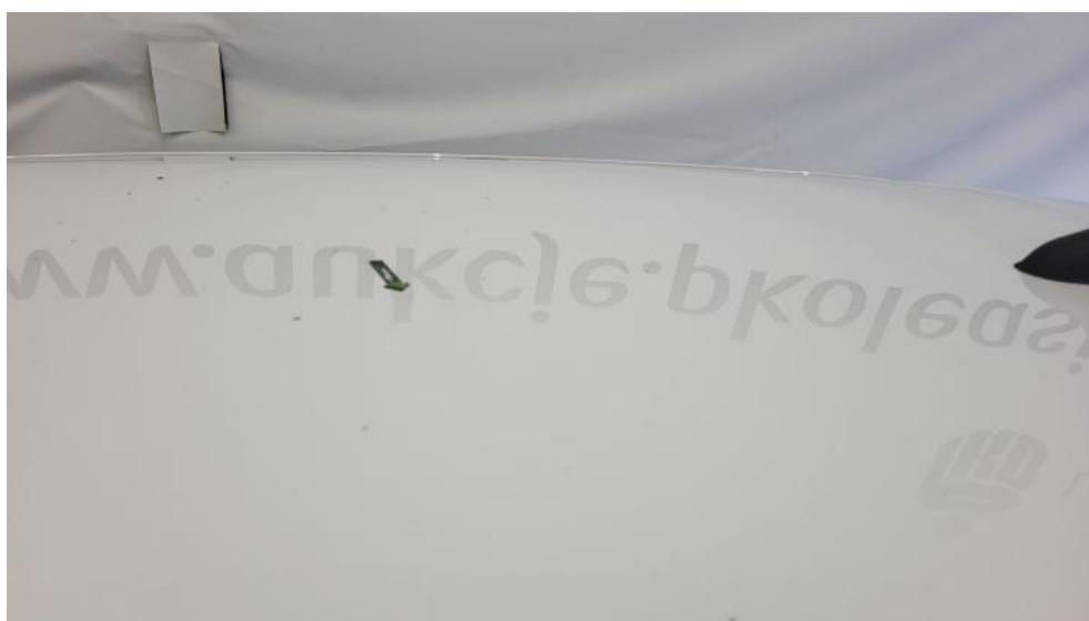
Fot. 42. Dach - Rysa/odprysk 1
