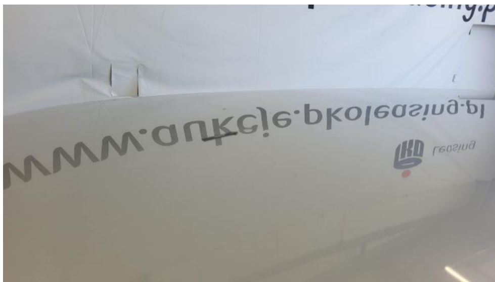
Fot. 61. Dach - Wgniecenie/odkształcenie 1
