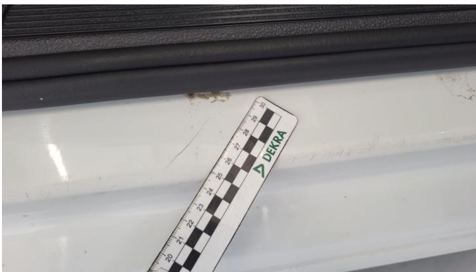
Fot. 63. Próg P - Rysa/odprysk 1
