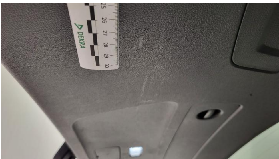
Fot. 70. Wykładzina pokrywy tylnej - Rysa/odprysk 1
