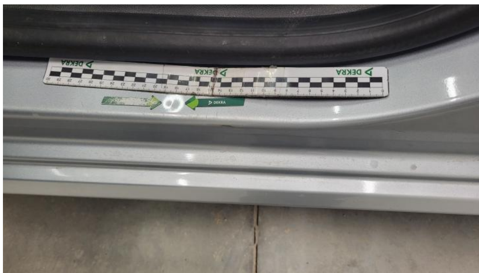
Photo 49. Próg L - Wgniecenie/odkształcenie 1
