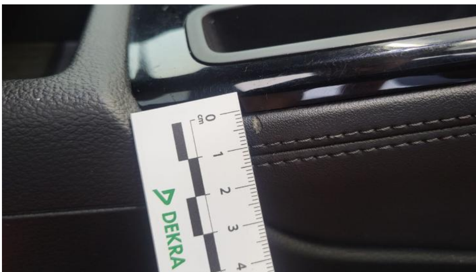
Photo 76. Konsola tunelu śr. - Pęknięcie/rozerwanie 1
