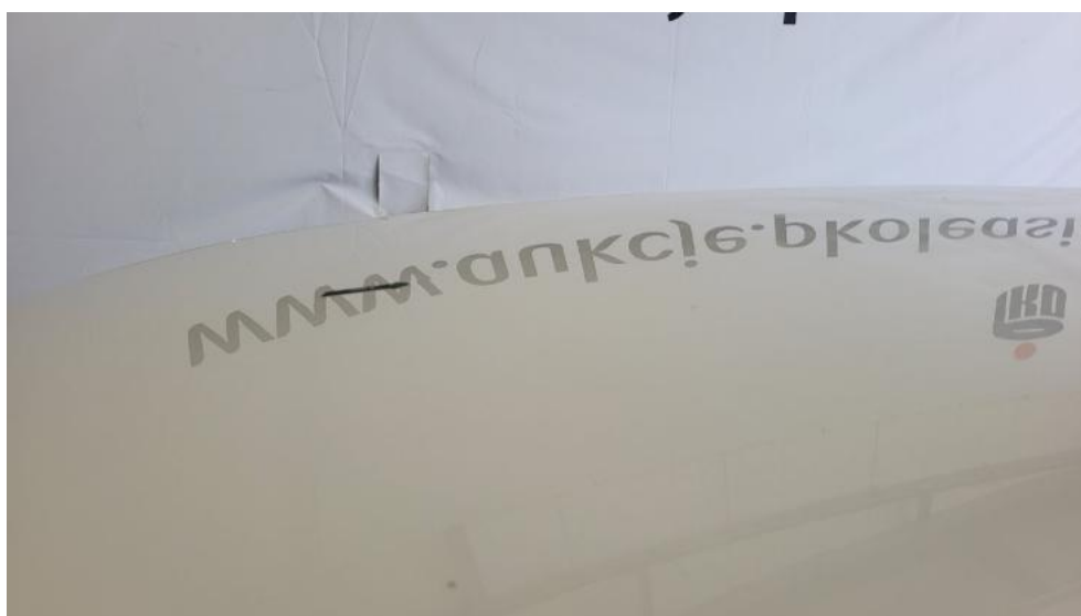
Fot. 46. Dach - Wgniecenie/odkształcenie 1
