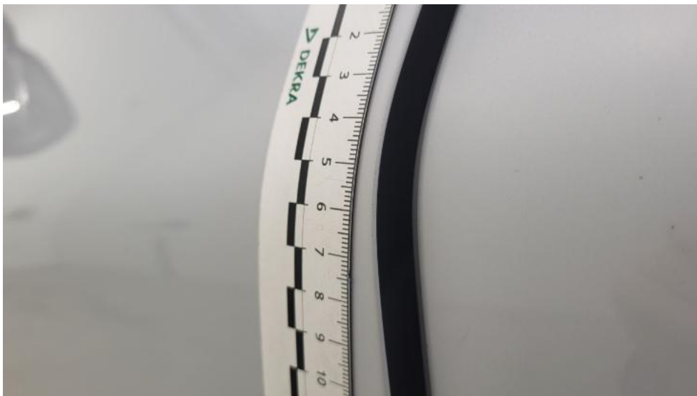
Fot. 55. Drzwi przed L - Rysa/odprysk 2
