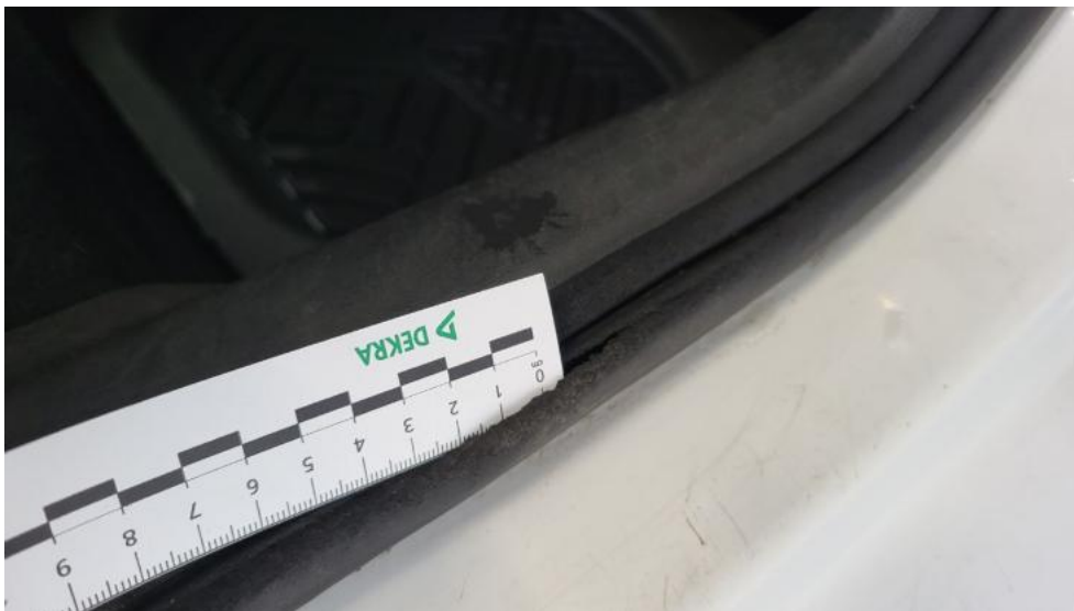
Fot. 105. Uszczelka drzwi tylnych P - Pęknięcie/rozerwanie 1
