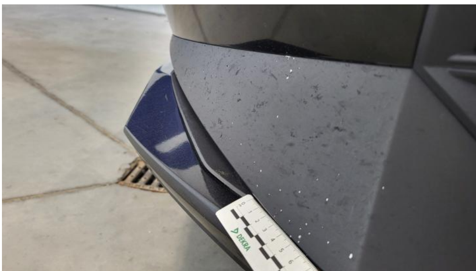
Fot. 50. Zderzak przedni cz L - Rysa/odprysk 1
