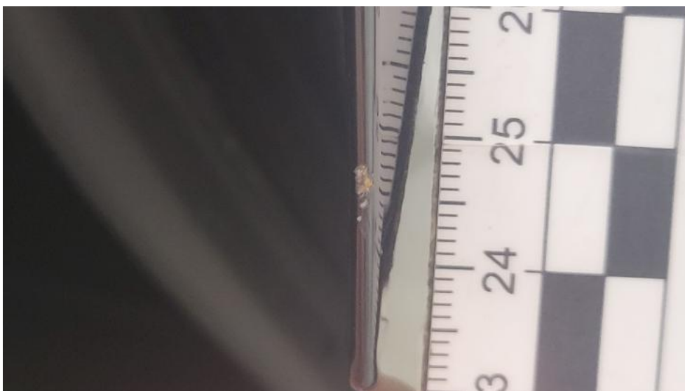
Photo 66. Drzwi tylne P - Inne 1
