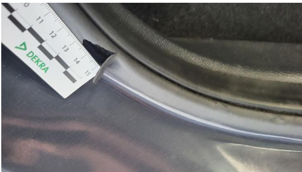
Photo 61. Uszczelka drzwi tylnych P - Pęknięcie/rozerwanie 1
