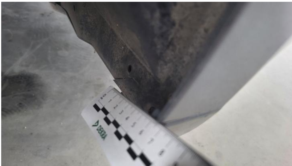
Fot. 59. Nadkole przednie P - Pęknięcie/rozerwanie 1
