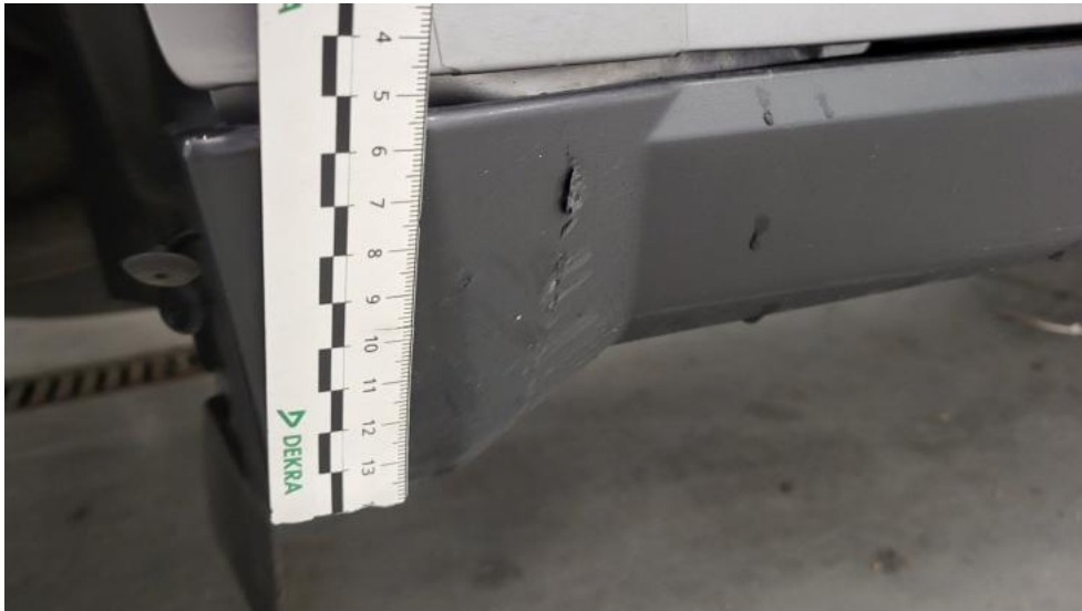
Fot. 69. Próg P - Rysa/odprysk 1
