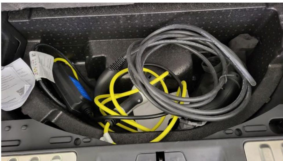
Photo 32. Przewód ładowania baterii trakcyjnej
